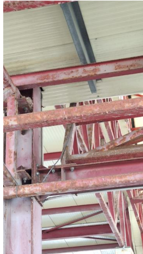
Structură din oțel afectată de coroziune
