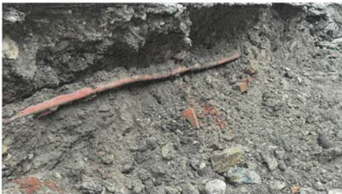
Foto nr. 6 - Cabiuri electrice functionale ingropate in spatele zidului in corpul trotuarului.
