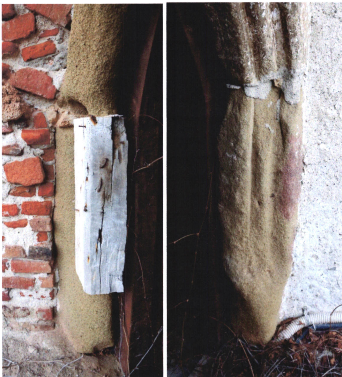
Imagini din partea inferioară a portalului (stânga, dreapta) cu zonele de dezagregare ce a dus la erodarea pe suprafață mare a materialului litic.
