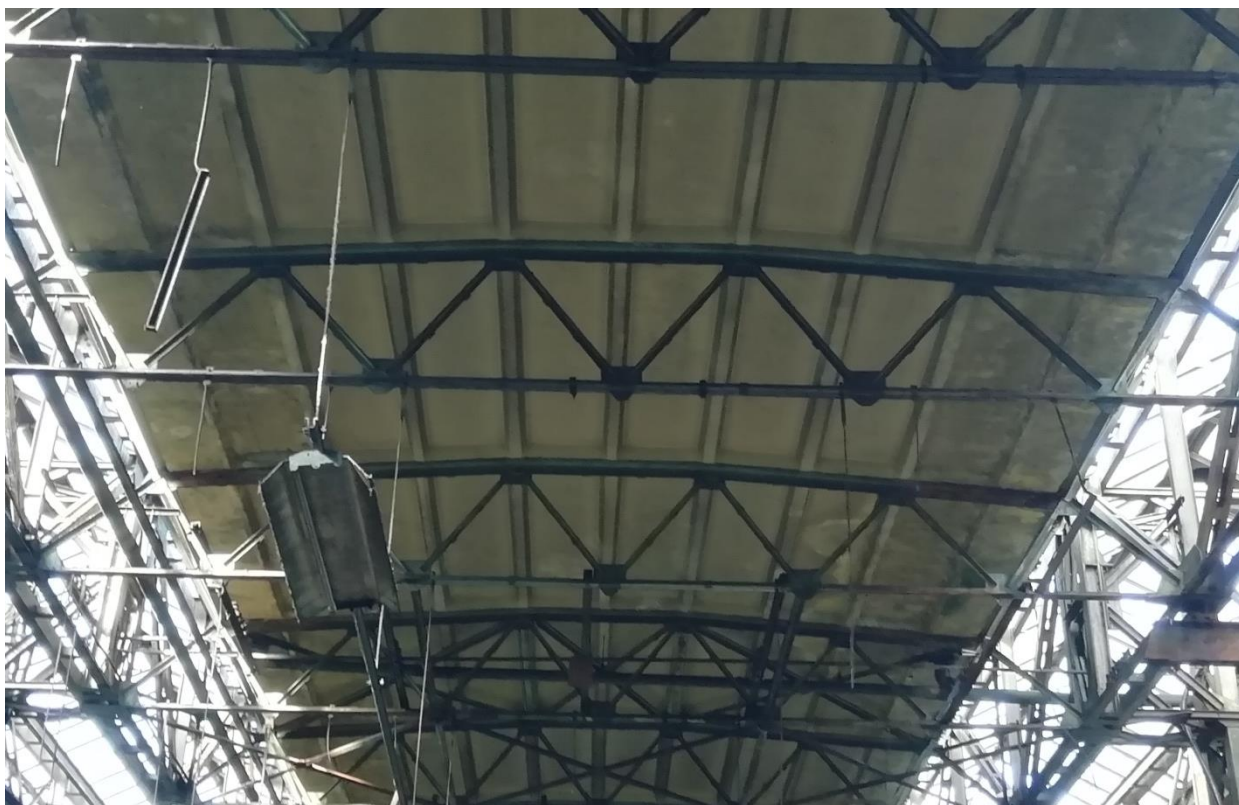
Secția pentru montaj rulmenți serie mare (C25a). Detaliu sistem de acoperire
