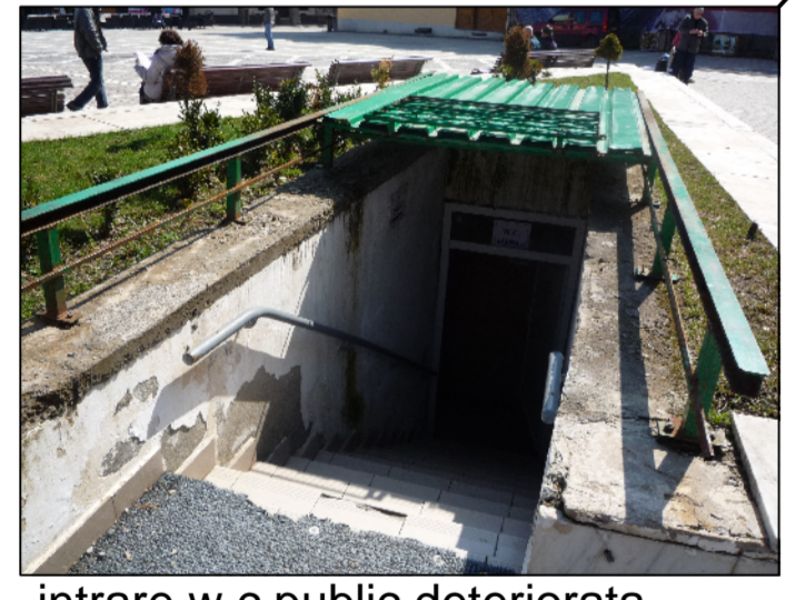
intrare w.c. public deteriorata
