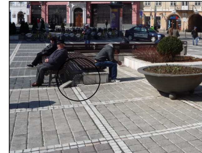
soclu banca deteriorat
