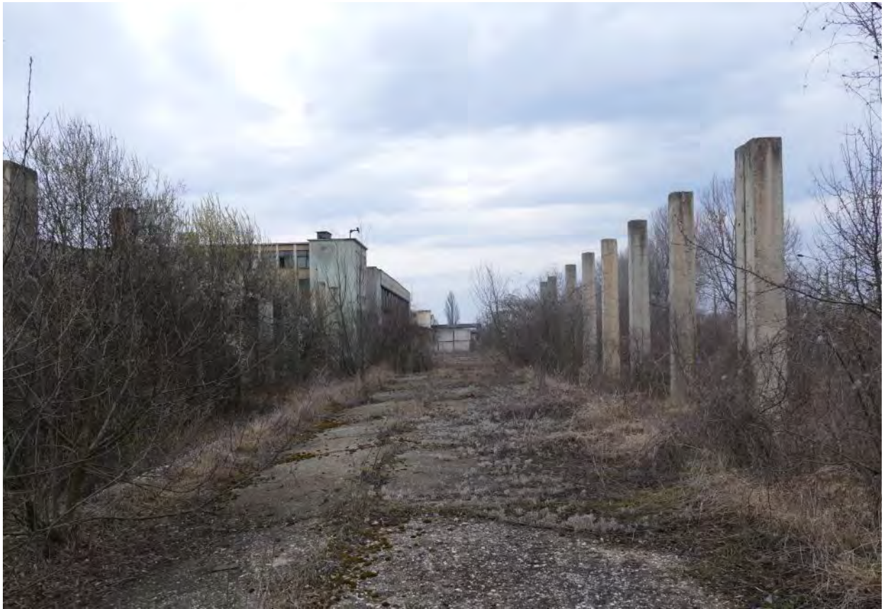
Aleea din spatele hangarelor în dreptul magaziei de oțeluri trase (C16), spre NV
