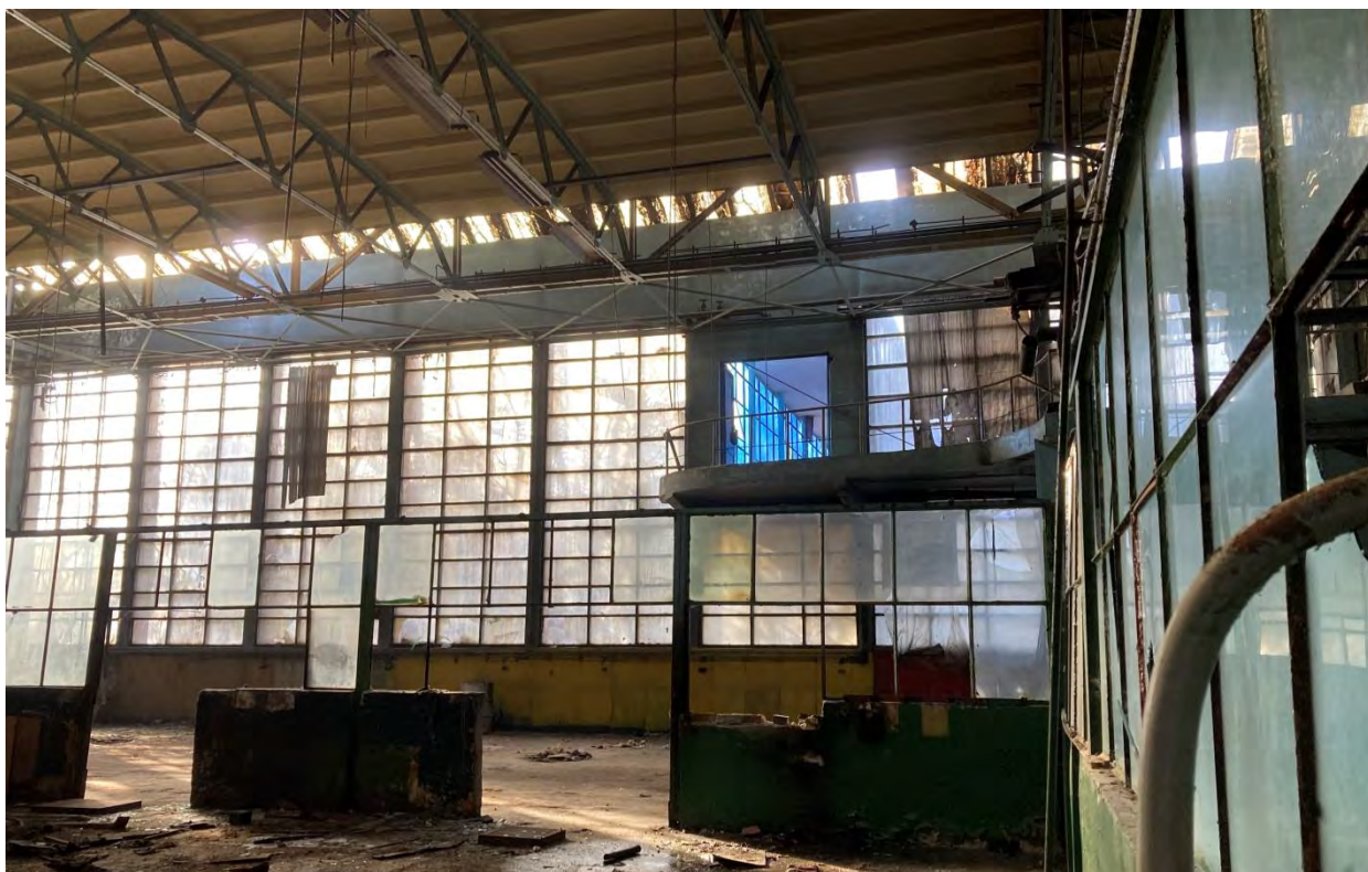
Secția pentru montaj rulmenți serie mare (C25a). Pasarela de legătură cu laboratorul uzinal (C21)
