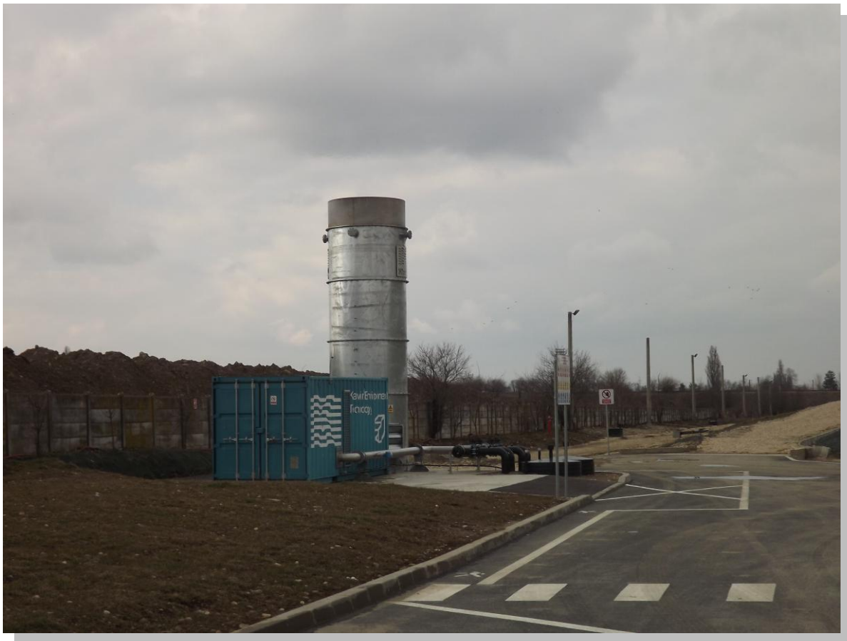
Figura nr. 5 - Instalația de ardere controlată a gazului de depozit
