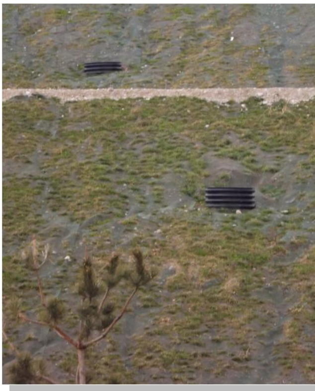
Figura nr. 6 – Puțuri de captare
