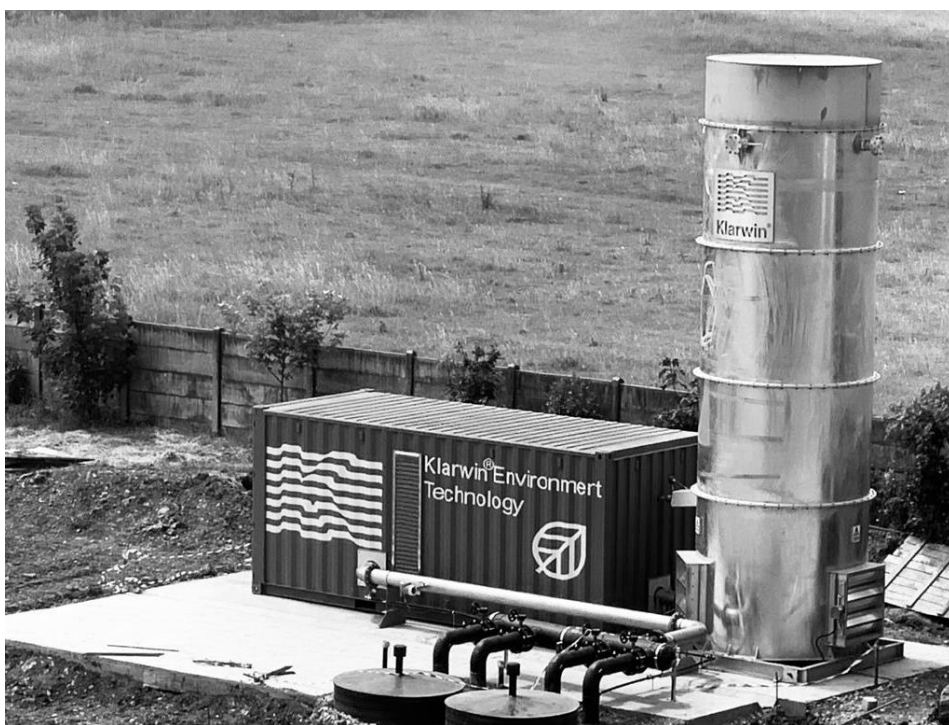
Figura nr. 3-10 Instalația de ardere la temperaturi înalte Sursa : foto KLARVIN
