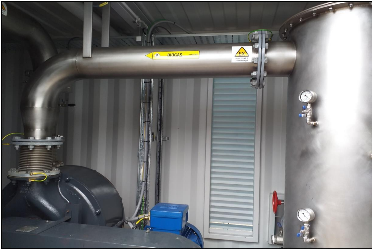
Figura nr. 3-7 Interior instalație de ardere la temperaturi înalte Sursa : foto ECO SIMPLEX NOVA
