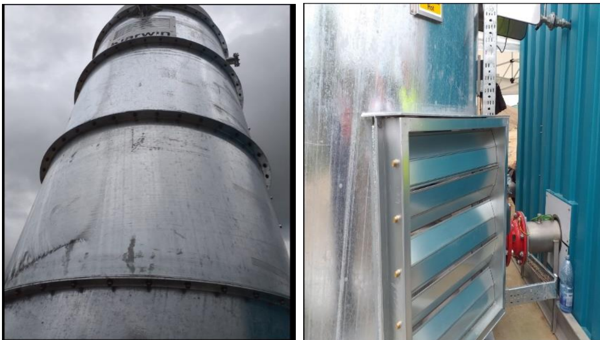
Figura nr. 3-8 Coș evacuare instalație de ardere Sursa : foto ECO SIMPLEX NOVA
