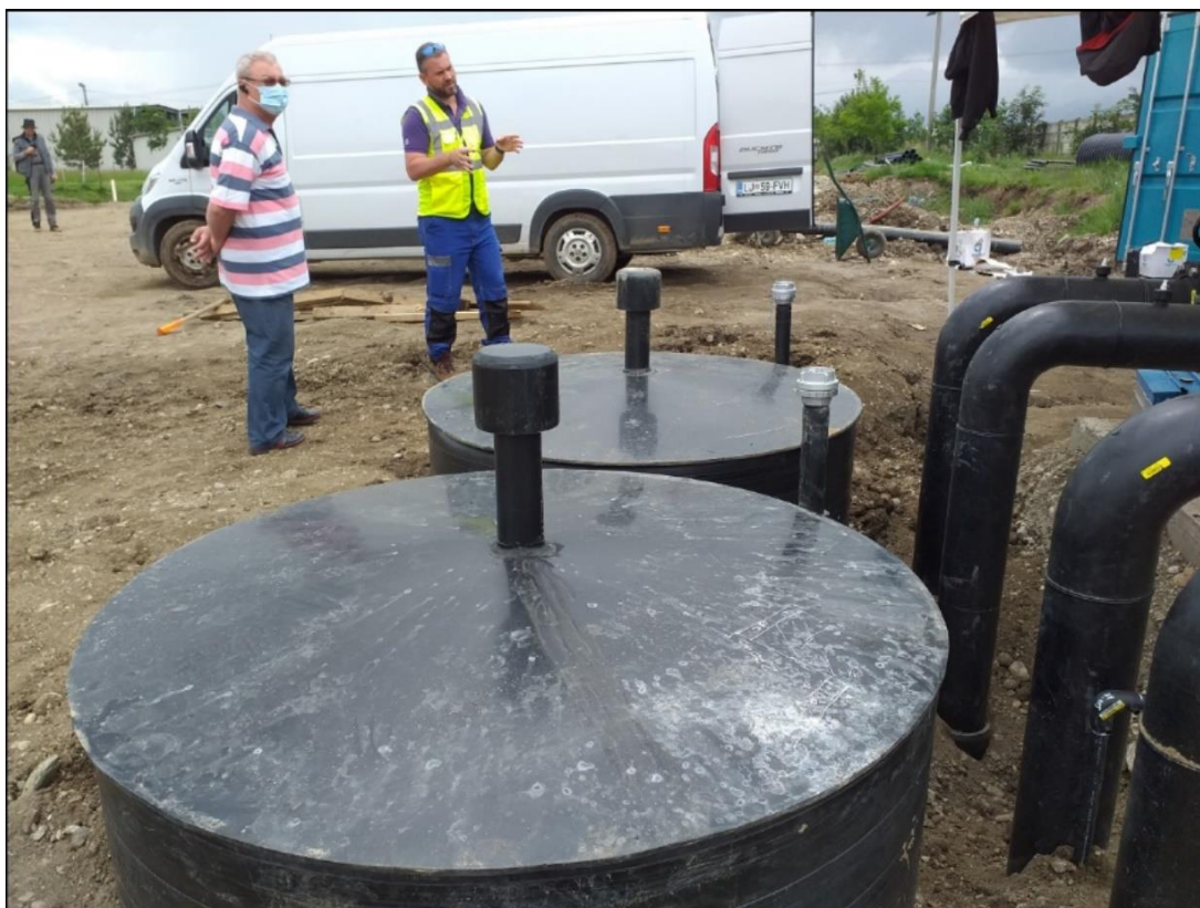
Figura nr. 3-5 Separatoare condens instalația de ardere gaz depozit
